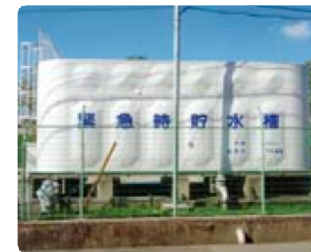
緊急時貯水槽
