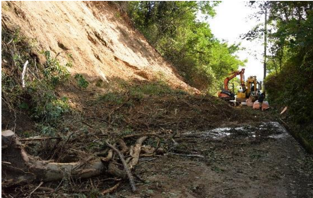
土砂の崩落により塞がれた道路 平成 29 年台風 21 号：柏原市高井田
