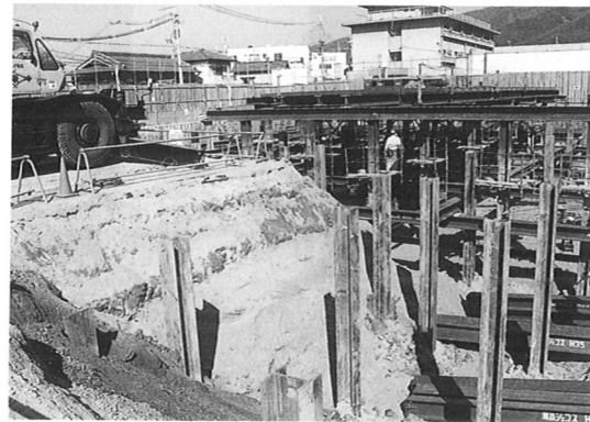
地下5mまで洪水で運ばれてきた砂ばかりだった（柏原病院新築工事現場）
