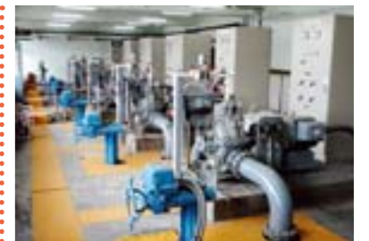
送水ポンプ 浄水池に貯めた水を配水池などに送ります。
