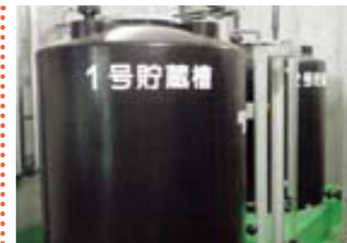
薬液注入室 原水を消毒するための薬品（次亜塩素酸ナトリウム）の貯留槽と注入設備があります。
